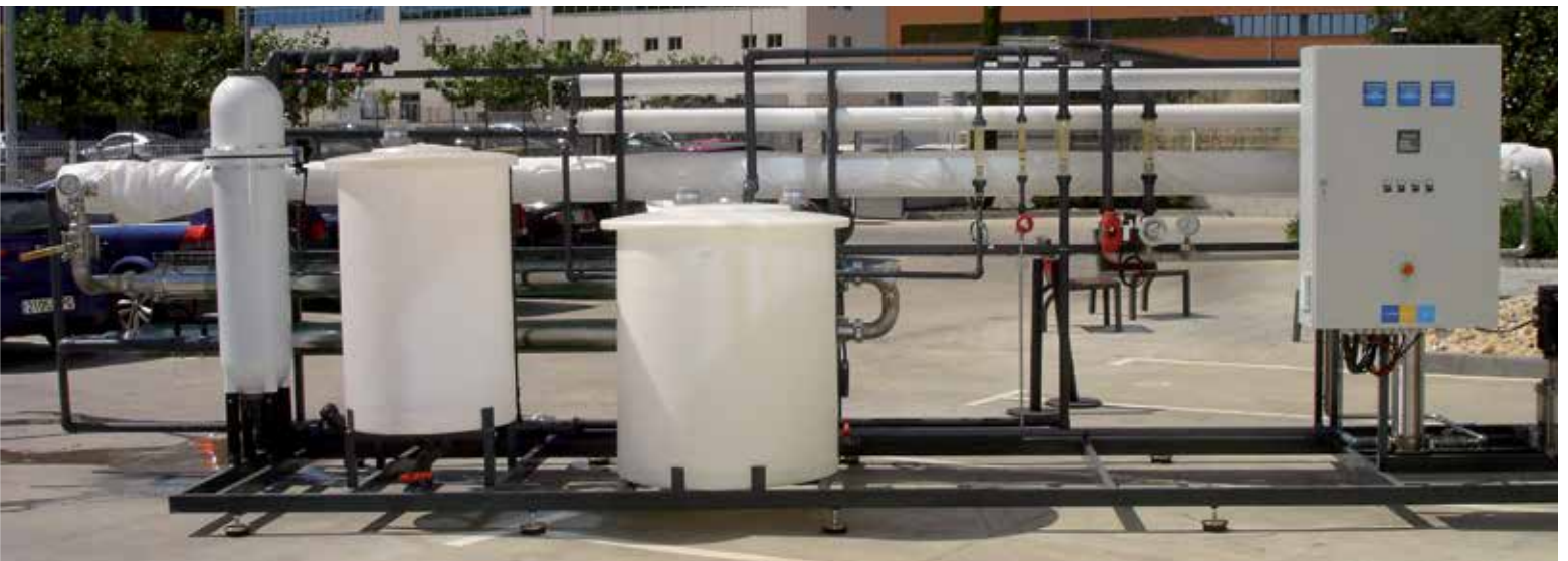
Planta de ósmosis de doble paso para producción de agua de alta calidad para lavado de automóviles.
