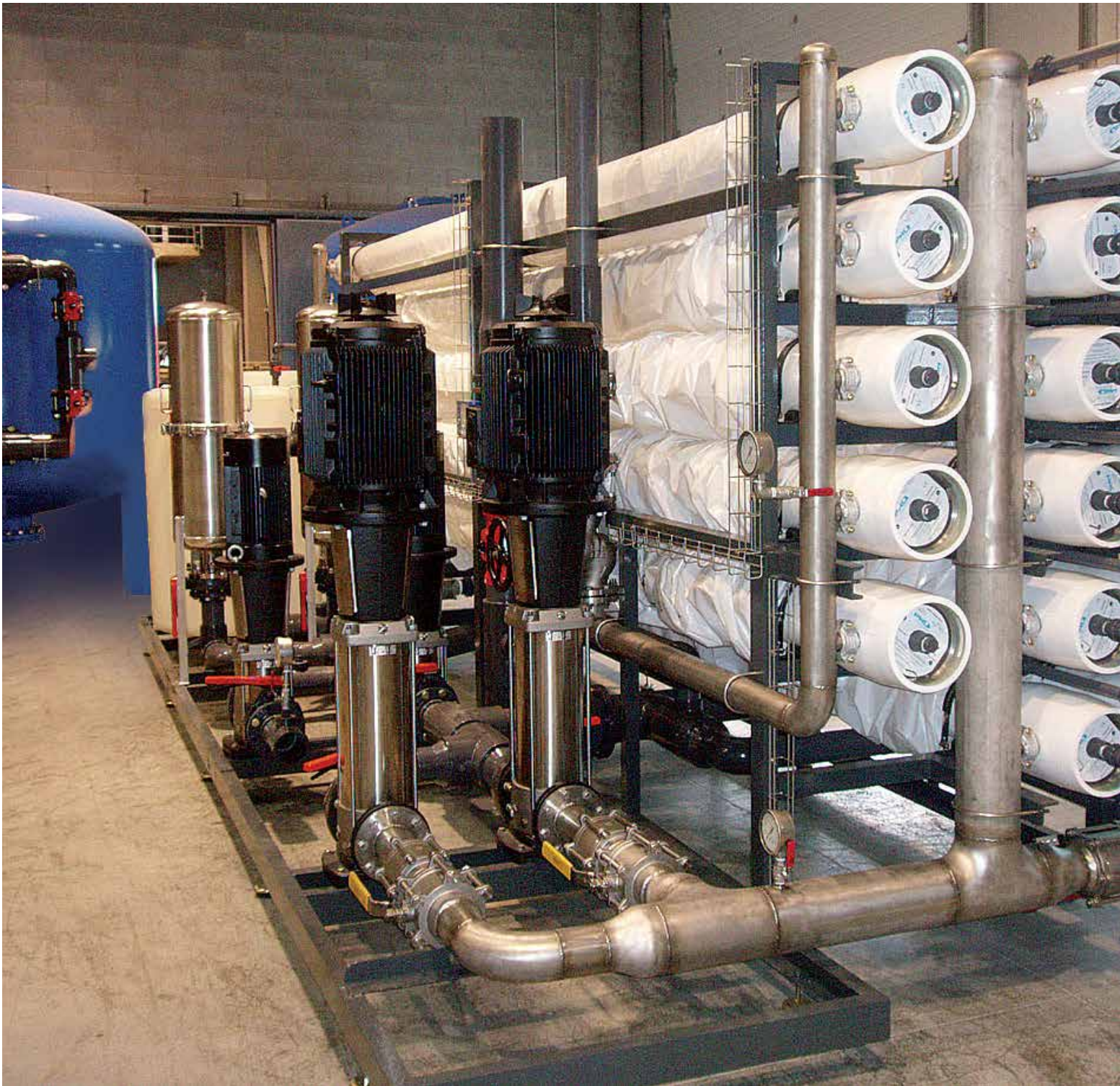
Planta de ósmosis para producción de agua en una industria química.
