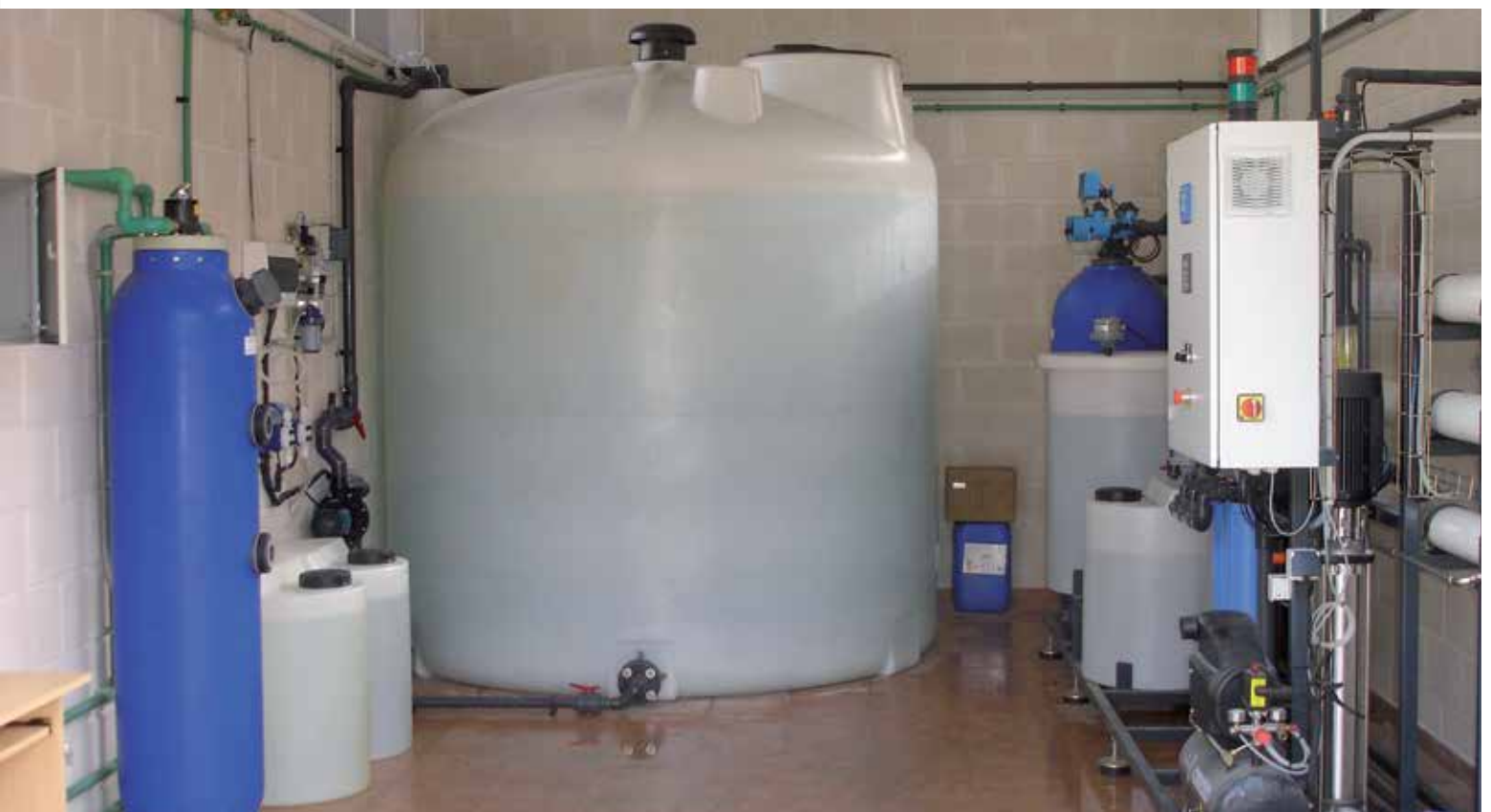
Planta de ósmosis de doble paso para abastecimiento de agua potable en una pequeña localidad del Mediterráneo.
